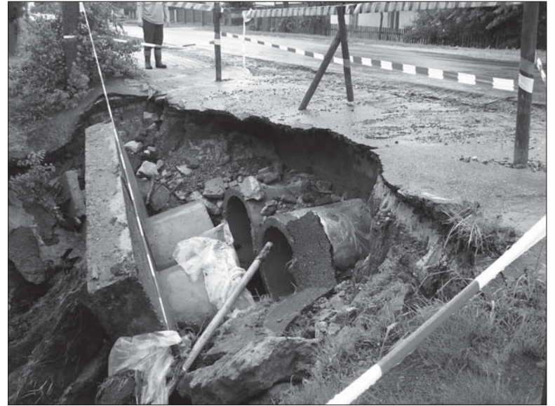
Tak po powodzi wyglądała droga relacji Księżpol – Łukowa.
